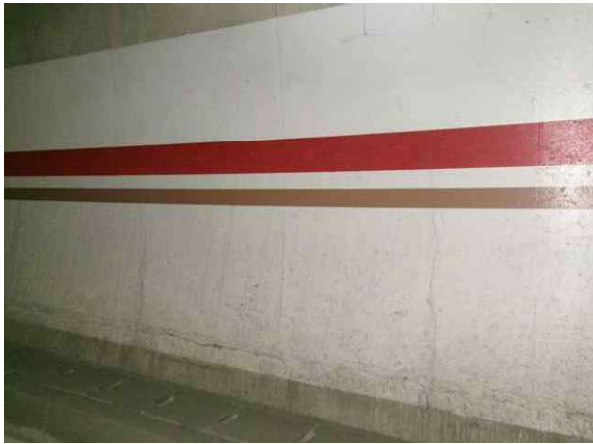
라이닝 S27 천단부 균열( C_w=0.3\text{mm} 미만)-서울방향
