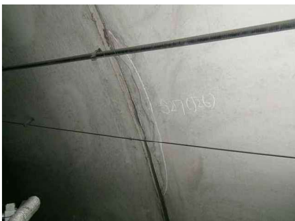
라이닝 S26 천단부 콘크리트 들뜸-서울방향
