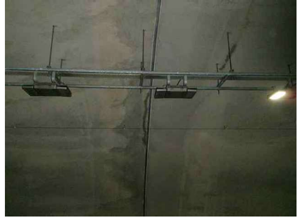
라이닝 S20 천단부 조인트부 들뜸-문산방향
