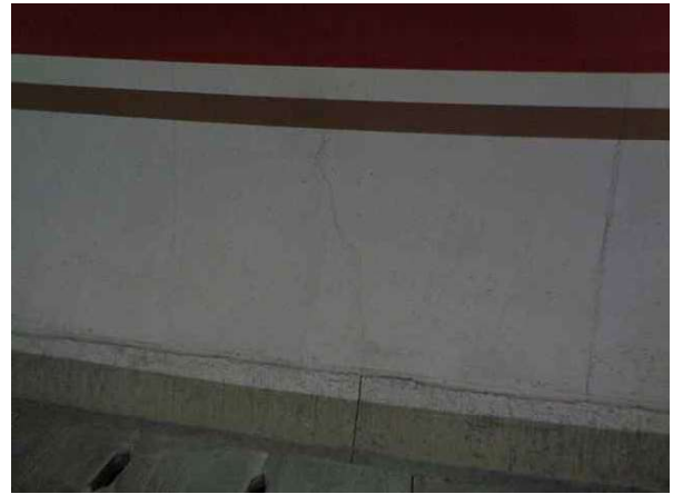
라이닝 S22 측벽부 균열( C_w=0.3\text{mm} 미만)-문산방향
