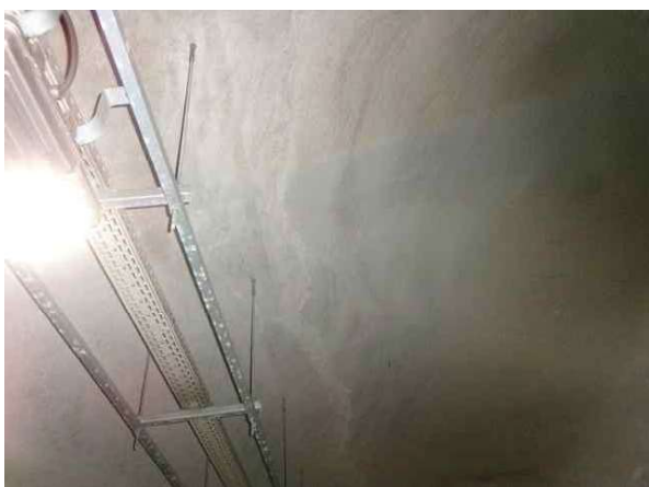
라이닝 S27 천단부 재균열( C_w=0.3\text{mm} 이상)-문산방향
