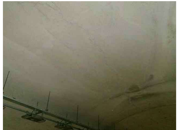
라이닝 S26 천단부 재균열(Cw=0.3mm이상)-서울방향
