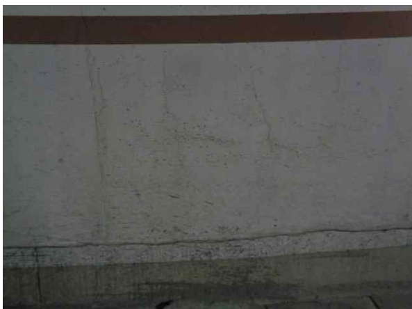
라이닝 S28 측벽부 망상균열-문산방향
