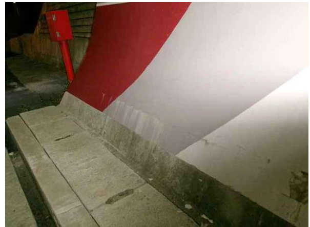
라이닝 S45 측벽부 하단 균열부 백태-문산방향
