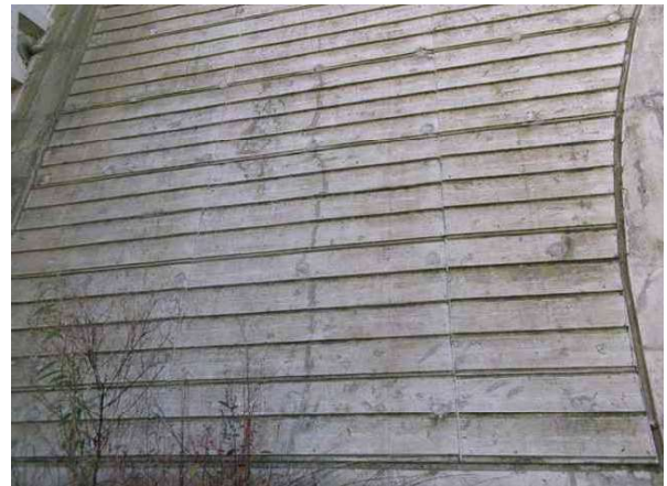
종점측 갭문 균열(Cw=0.3mm미만)-문산방향
