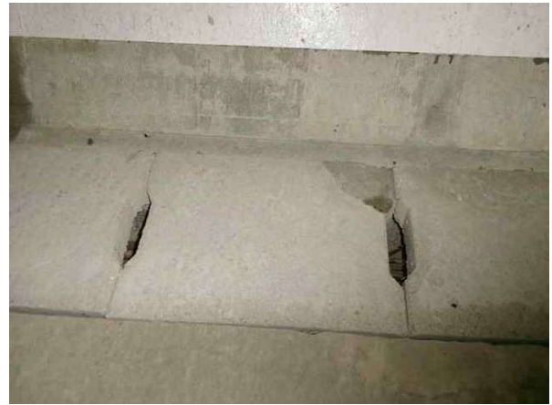
공동구 S44 뒹개파손-서울방향
