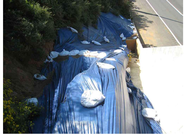
시점측 갭문 측면 토사유실 임시보수-문산방향
