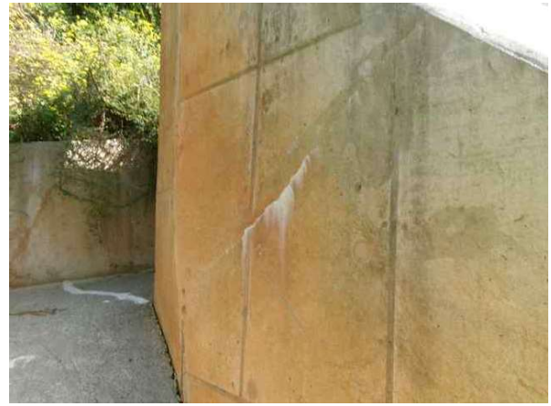
시점측 갭문 배수로 균열부 백태-서울방향
