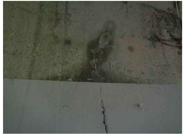
라이닝 S29 측벽부 균열( C_w=0.3\text{mm} 이상)-서울방향
