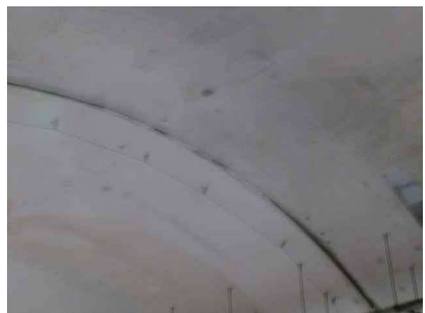
라이닝 S02 천단부 폐콘크리트 미제거-서울방향
