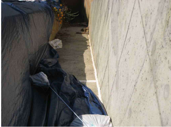
시점측 갭문 측면 토사유실 임시보수-문산방향
