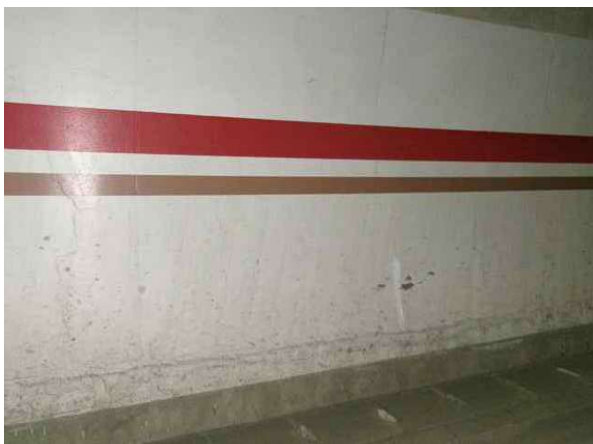
라이닝 S32 측벽부 망상균열-서울방향
