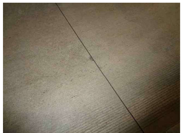
포장부 S39 포장부 파손-문산방향
