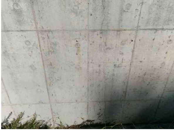
중점측 갭문 균열(Cw=0.3mm미만)-서울방향
