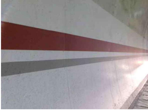
라이닝 S03 측벽부 망상균열-서울방향
