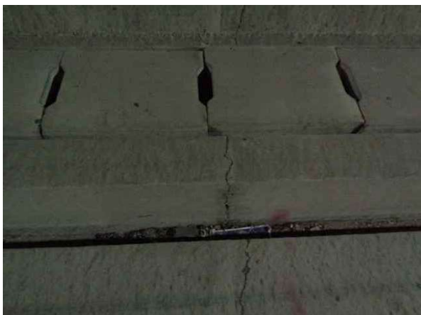
공동구 S20 균열( Cw=0.3\text{mm} 이상)-서울방향
