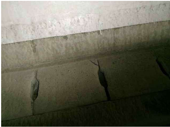
공동구 S20 뒹개파손-서울방향
