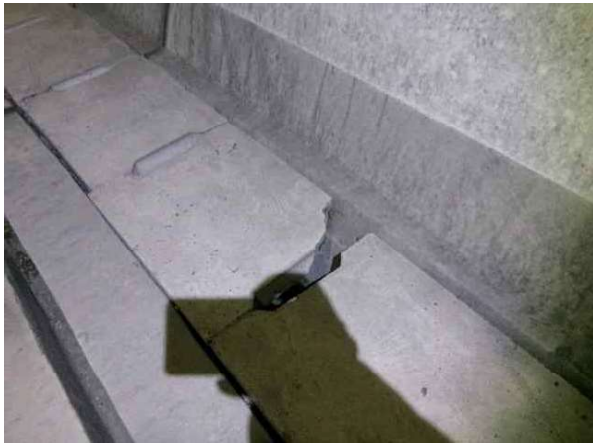
공동구 S40 덮개 파손-문산방향
