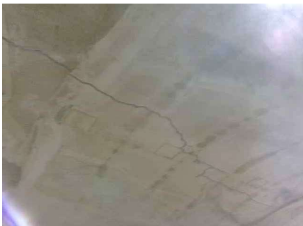
라이닝 S28 천단부 재균열(Cw=0.3mm이상)-서울방향
