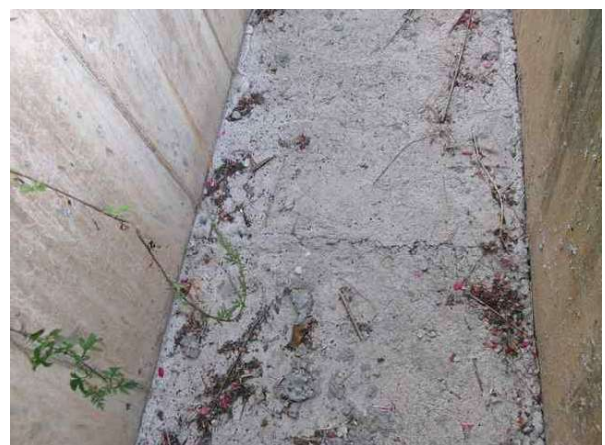
중점측 갭문 균열( C_w=0.3\text{mm} 미만)-문산방향
