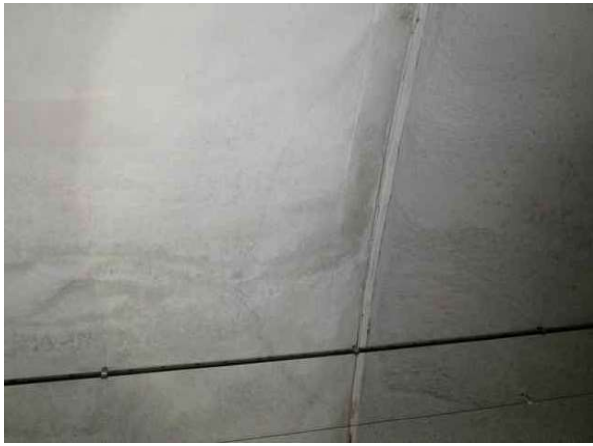
라이닝 S23 천단부 균열(Cw=0.3mm미만)-서울방향
