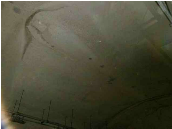
라이닝 S09 천단부 균열(Cw=0.3mm이상)-서울방향
