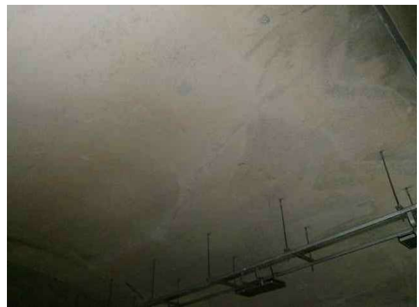
라이닝 S21 천단부 균열( C_w=0.3\text{mm} 미만)-문산방향
