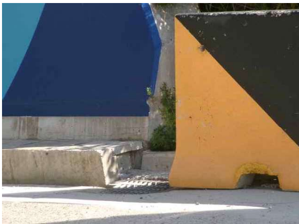
시점측 갭문 파손-문산방향
