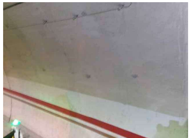
라이닝 S28 천단부 망상균열-서울방향
