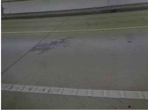
포장부 S04 망상균열-문산방향
