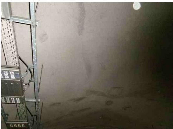
라이닝 S07 천단부 균열( C_w=0.3\text{mm} 이상)-문산방향
