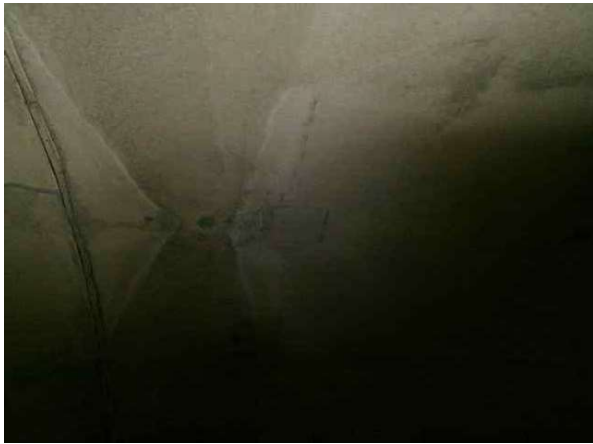
라이닝 S17 천단부 균열(Cw=0.3mm미만)-서울방향
