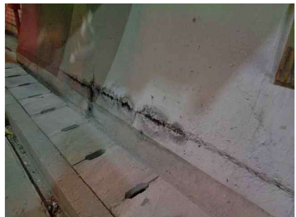
라이닝 S36 측벽부 하단 누수흔적-문산방향
