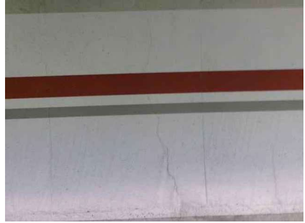
라이닝 S09 측벽부 균열( C_w=0.3\text{mm} 이상)-서울방향
