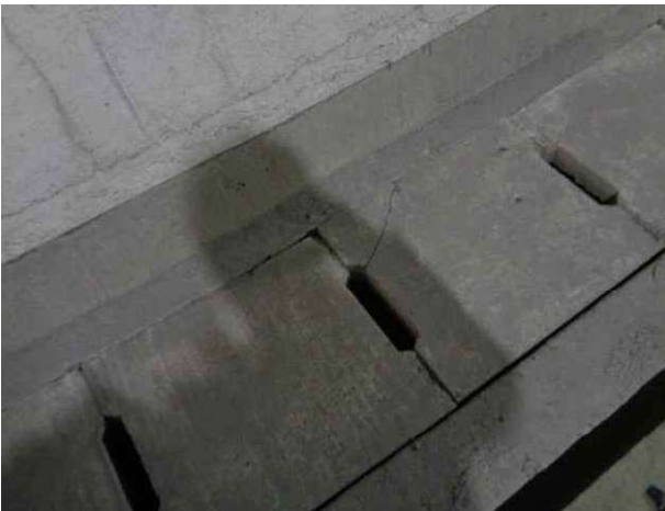
공동구 S07 덮개파손-서울방향
