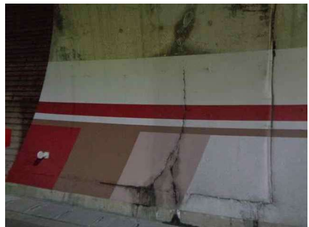
라이닝 S01 측벽부 균열부 누수-서울방향
