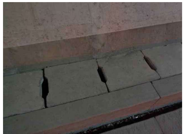
공동구 S39 덮개 파손-서울방향
