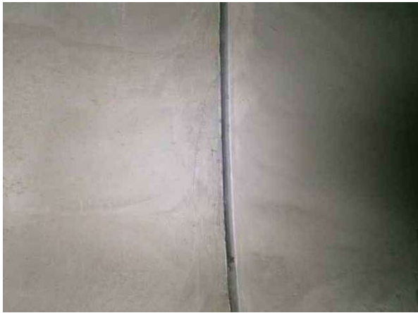
라이닝 S14 천단부 균열( Cw=0.3\text{mm} 미만)-서울방향
