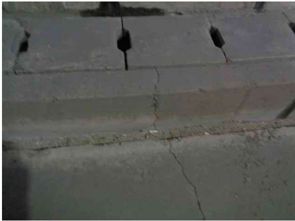
공동구 S20 균열(Cw=0.3mm이상)-서울방향
