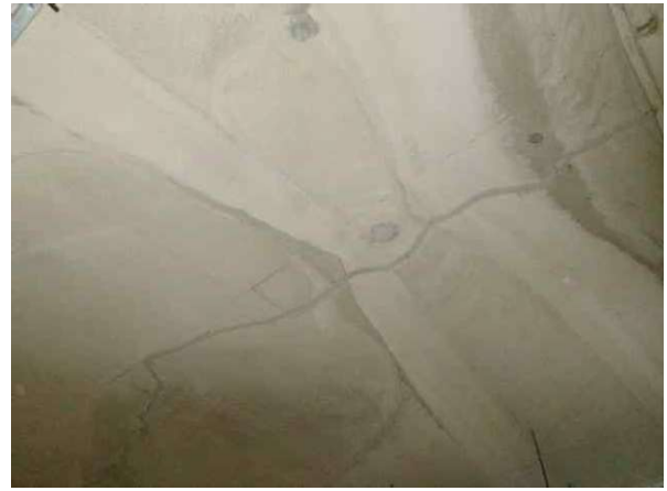
라이닝 S05 천단부 균열(Cw=0.3mm이상)-서울방향
