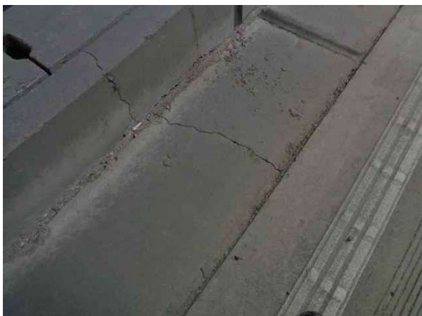
포장부 S01 균열-서울방향
