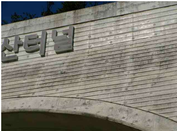
시점측 갭문 균열(Cw=0.3mm미만)-문산방향
