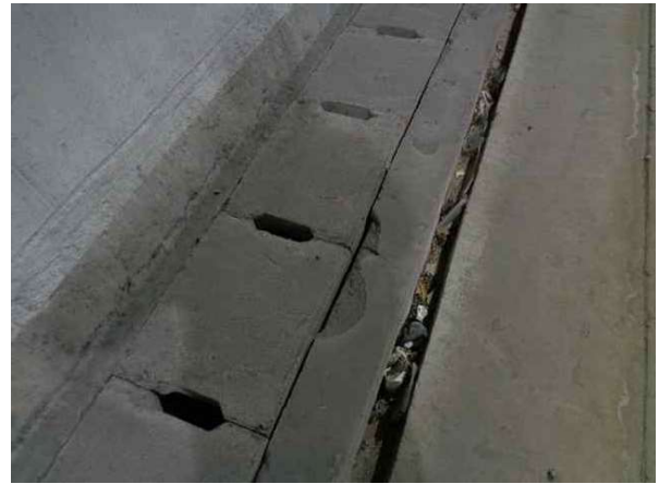
공동구 S21 파손-서울방향
