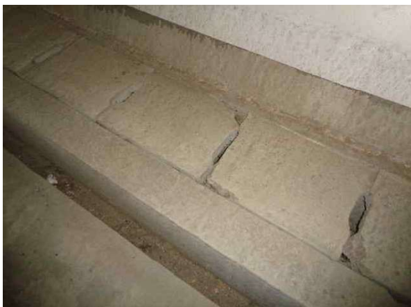
공동구 S12 덮개파손-문산방향
