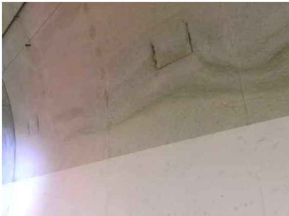
라이닝 S28 측벽부 균열( C_w=0.3\text{mm} 미만)-서울방향
