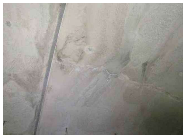
라이닝 S15 천단부 백태-문산방향
