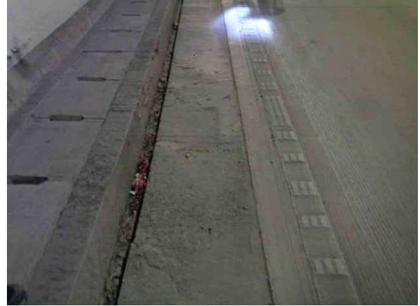
포장부 S39 갓길측 파손-문산방향
