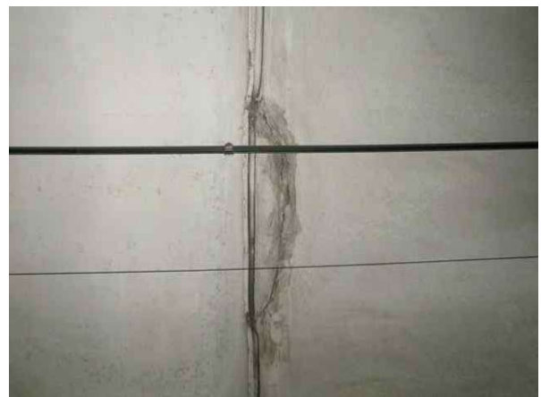
라이닝 S10 천단부 콘크리트 들뜸-서울방향
