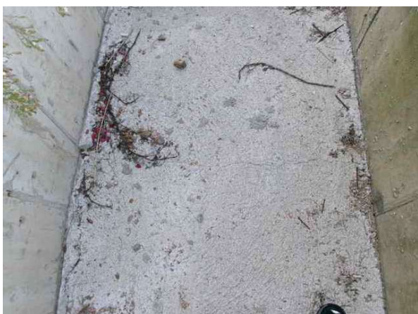
중점측 갭문 균열( C_w=0.3\text{mm} 미만)-서울방향
