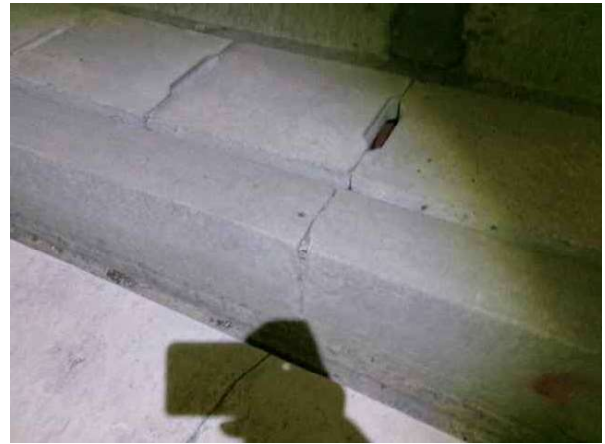
공동구 S08 균열(Cw=0.3mm미만)-문산방향
