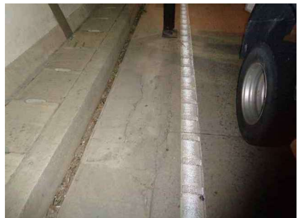
포장부 S35 갓길측 파손-서울방향
