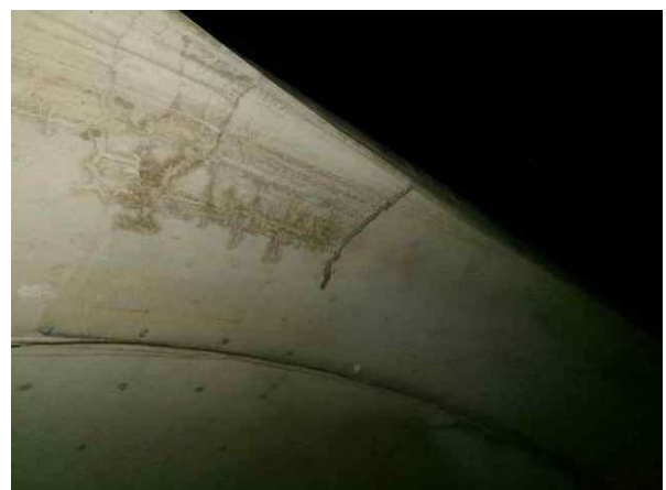
라이닝 S01 천단부 균열부백태-서울방향
