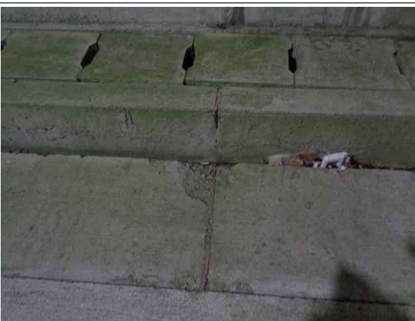
포장부 S43 갓길측 파손-서울방향
