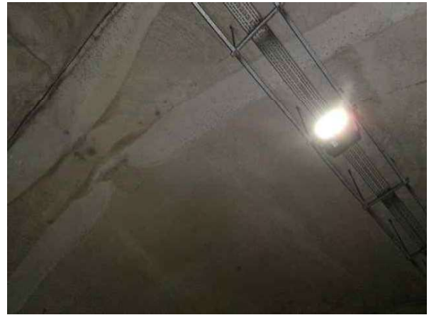
라이닝 S08 천단부 균열(Cw=0.3mm이상)-서울방향
