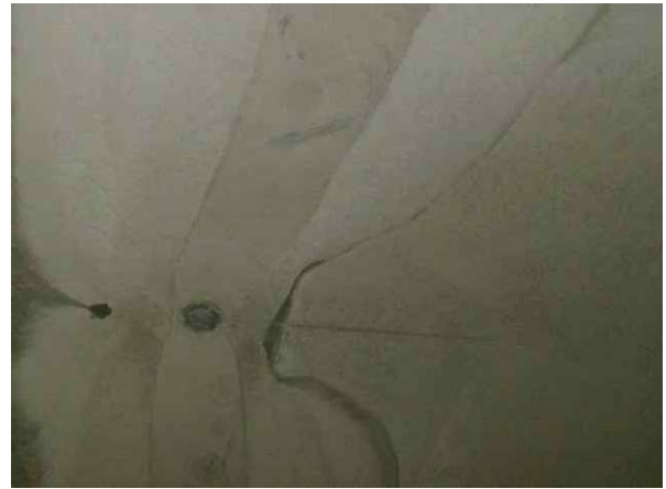
라이닝 S05 천단부 균열(Cw=0.3mm이상)-서울방향
