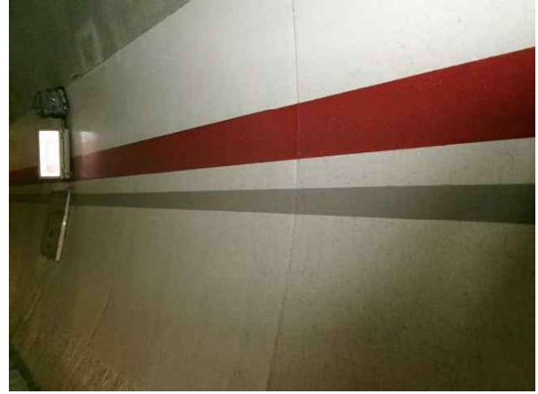
라이닝 S32 측벽부 망상균열-문산방향
