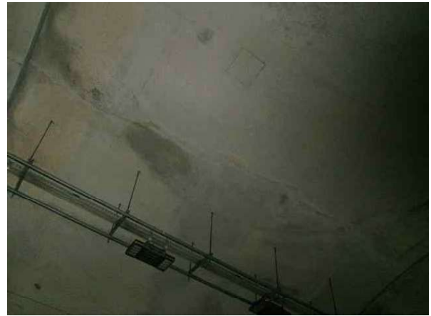
라이닝 S24 천단부 균열( Cw=0.3\text{mm} 이상)-서울방향
