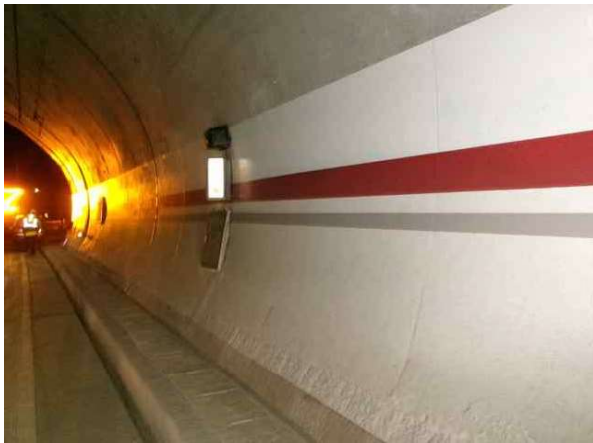
라이닝 S40~42 측벽부 망상균열-문산방향
