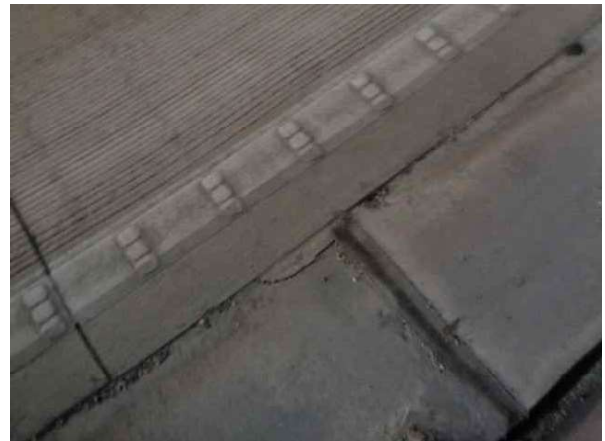
포장부 S32 파손-문산방향
