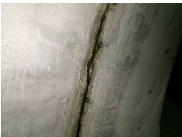
라이닝 S45 천단부 조인트부 들뜸-서울방향
