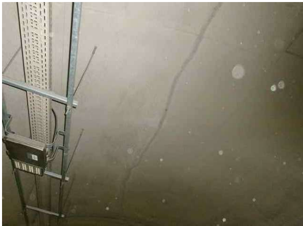
라이닝 S10 천단부 재균열(Cw=0.3mm미만)-서울방향
